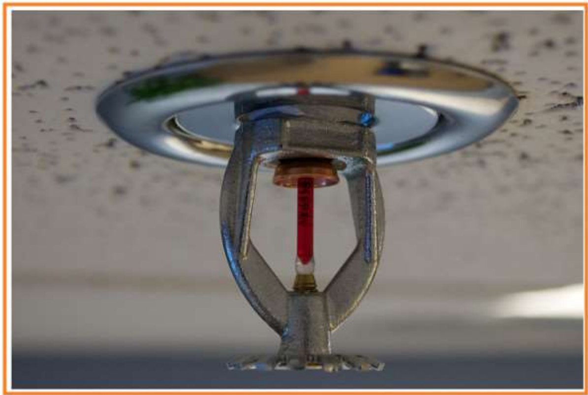
Brandon Leon - Flickr . Rociador de techo (CC BY-SA)
