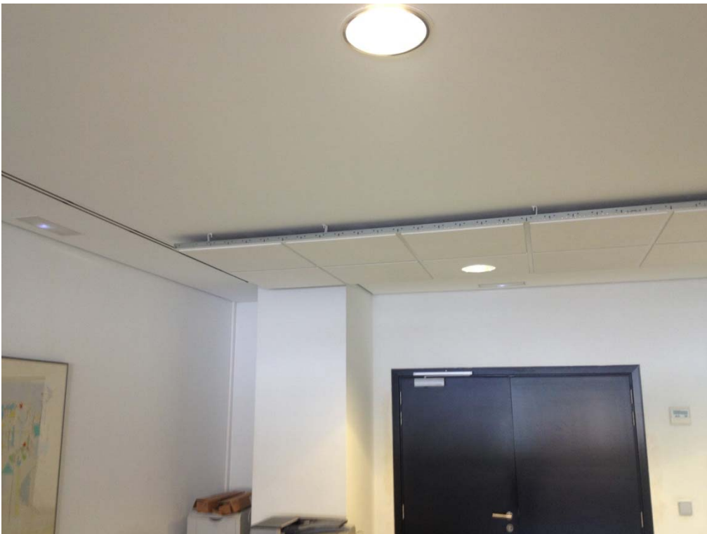
Retorno climatización, despacho administración
