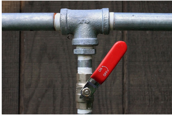
instalación realizada con tubería y accesorios de acero galvanizado (Pixabay License)
