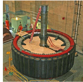
Wikipedia. Rotor o inductor de un generador de gran potencia (CC0)
